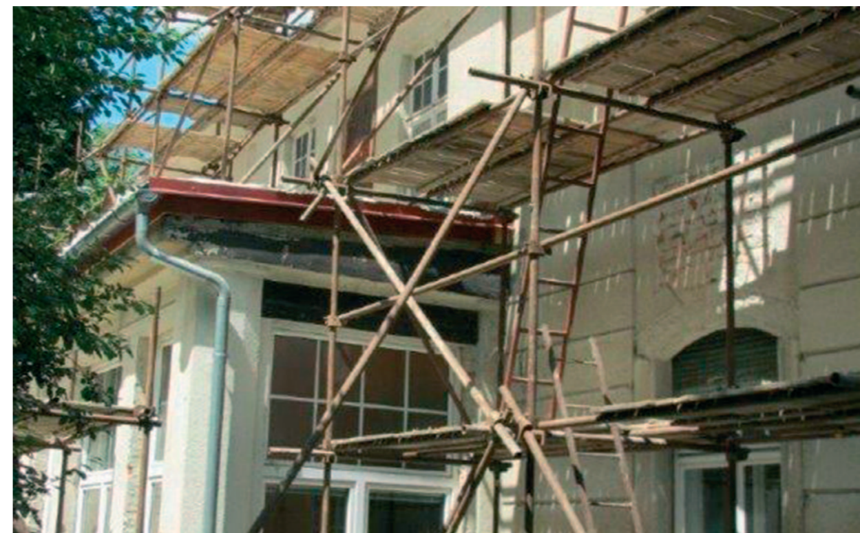
O kus dál se připravuje budova mateřské školy k zateplení a posledním úpravám
