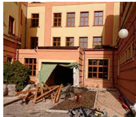
Zahájili jsme největší investiční akci posledního desetiletí - přístavbu odborné učebny a zajištění bezbariérovosti v budově základní školy
